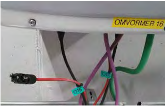
Un connecteur d'onduleur fondu.
